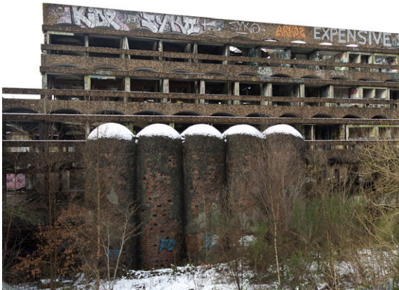
De 'Corbusiaanse' lichthappers en de huidige staat van de stenen gevel
